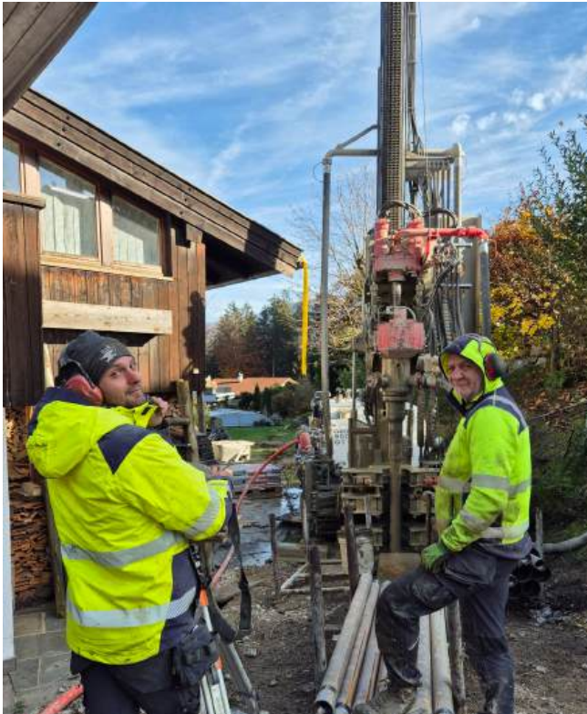
Mario und Jürgen vom #1aINSTALLATEUR Wärmepumpen Tirol in Kundl bringen die Wärme aus der Erde ins Wohnzimmer.
